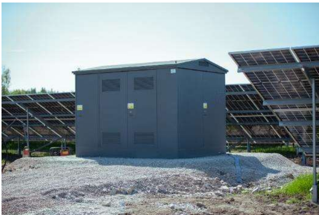
Kuva 6. Esimerkki aurinkopuistoon sijoitetusta muuntajaasemasta. Lähde: Helios Nordic Energy AB:n aurinkopuisto Kungsåra.
