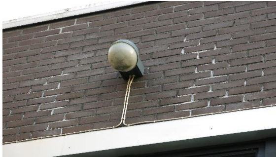
Julkisivun tiiliverhouksen ulkopinnassa on merkkejä voimakkaasta kosteusrasituksesta koko rakennuksen alueella (vrt. myös havainnot yläpohjasta).
