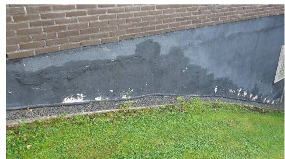
Arkiston (tila 100) kohdalla korjausmaalatussa sokkelissa uutta vauriota.
