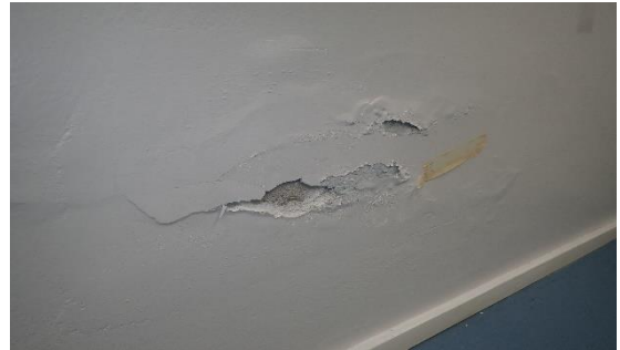
Arkiston maanvastaisissa seinissä oli kosteuden aiheuttamia maali- ja tasoitevaurioita.
