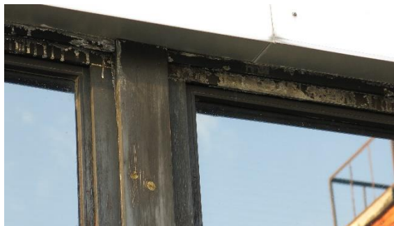
Puuikkunoiden puitteet ja listoitukset ovat monin paikoin kärsineet huomattavasta kosteusrasituksesta.
