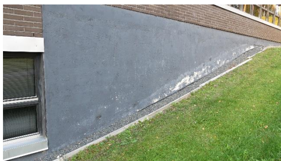
Sokkelin maalipinnan hilseilyä käsikirjaston (tila 101) ja arkiston (tila 100) kohdalla.
