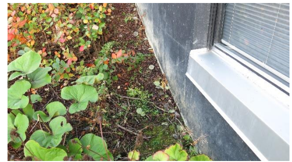
Kellarikerroksen maanvastaisiin seiniin kohdistuu ylimääräistä kosteusrasitusta vääränlaisten maa-ainesten ja maanpintojen puutteellisen kallistuksen vuoksi.
