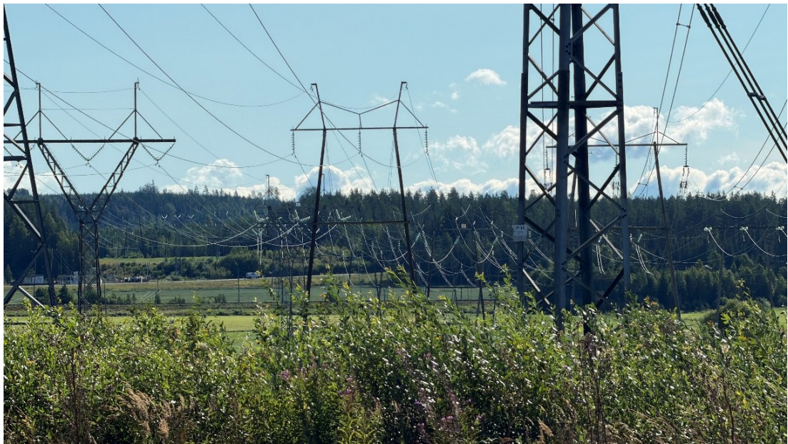
Kuva 9: Kuva Alapitkän sähköasemalta kohti valtatiötä 5.
