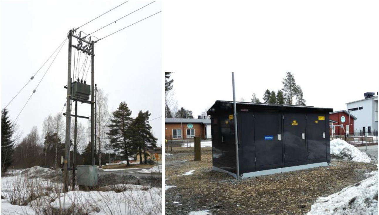
Kuva 6. Vasemmalla pylväsmuuntamo ja oikealla puistomuuntamo (Päivi Ryhänen).
