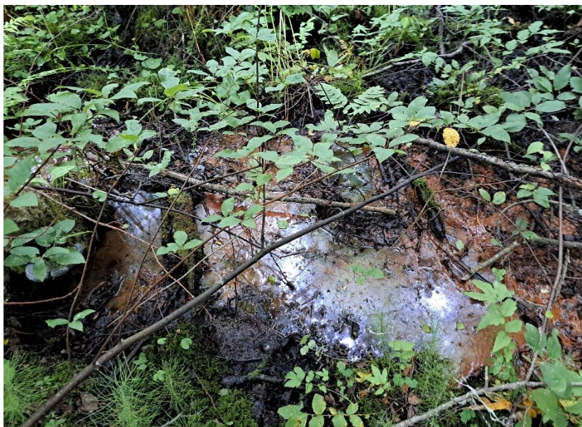
Kuva 2. Pohjaveden purkautumisen aiheuttamaa ruostevärjäymää.
